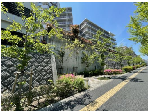
セットバックした石積み擁壁の前面に植栽を施した例
