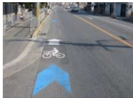
写真 5-19 路面表示設置例(吹田市)
