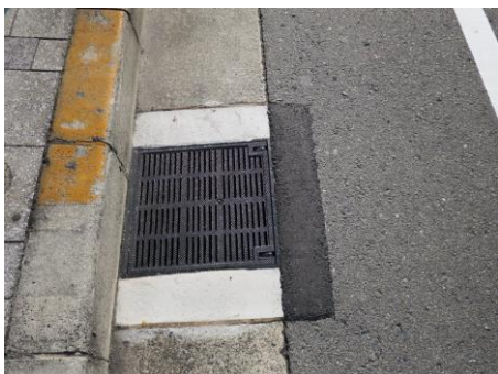
グレーチング蓋の格子間隔を狭め、滑り止め加工している例 (大阪市)
