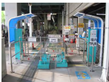
写真 5-37 機械式出入口ゲート(吹田市)
