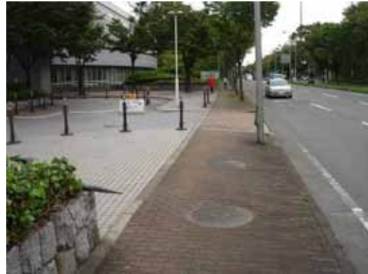
視覚障害者誘導用ブロックの不備
