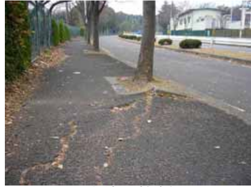
ほそう ろうきゆうか 舗装の老朽化
