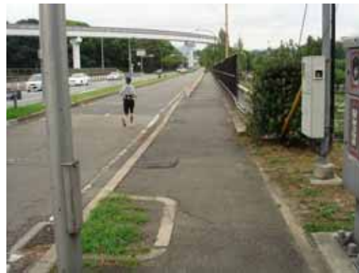
舗装の老朽化
