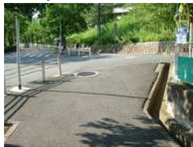
すりつけ部の勾配が大きい
