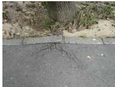
舗装の老朽化
