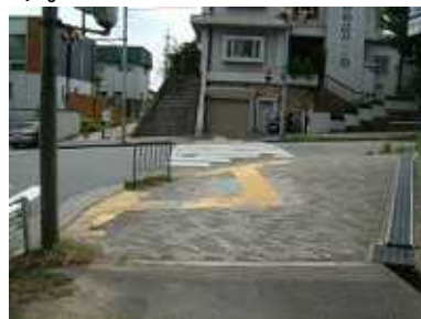
すりつけ部の勾配が大きい
