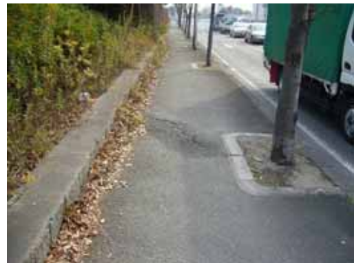
舗装の老朽化
