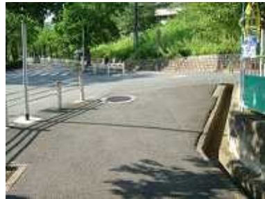
すりつけ部の勾配が大きい
