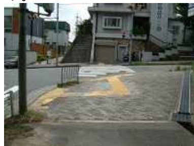
すりつけ部の勾配が大きい
