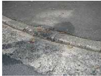
ほどう しゃどう だんき ああ 歩道と車道の段差が大きい
