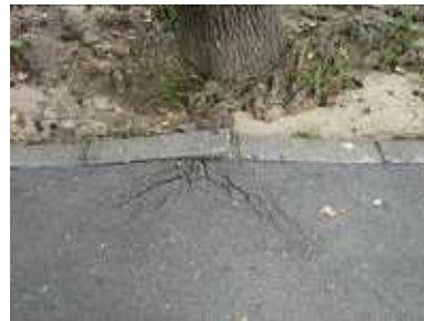
舗装の老朽化
