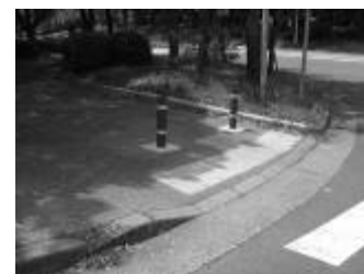
視覚障害者誘導用 ブロックの不備
