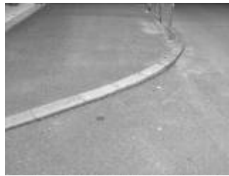
ほどう しやどう だんさ あお 歩道と車道の段差が大きい
