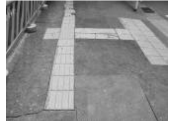
舗装・視覚障害者誘導用 ブロックの老朽化
