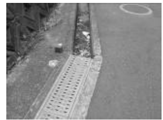
みぞぶた ふ び 溝蓋の不備
