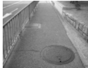
路面舗装の老朽化
