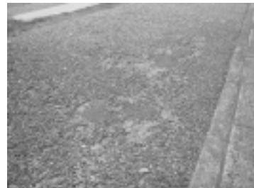
路面舗装の老朽化
