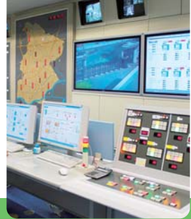
電算機器を更新した浄水管理センター
