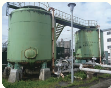
昭和46年に建造された 片山浄水所高速ろ過機
