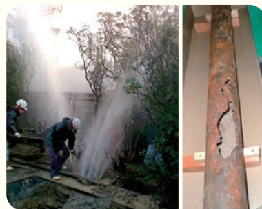
漏水事故現場の状況と 老朽化した水道管
