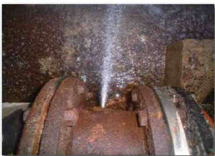
管路の老朽化と漏水
