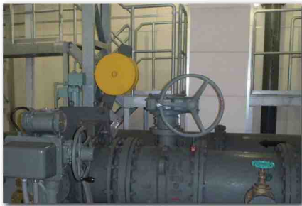
緊急遮断弁 （千里山配水場）
