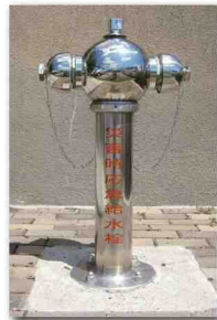
災害時緊急給水栓 （泉浄水所）
