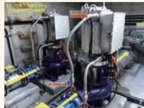
マイクロ水力発電システム
