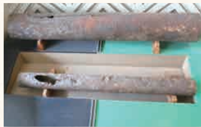
写真7-3 老朽化した水道管
