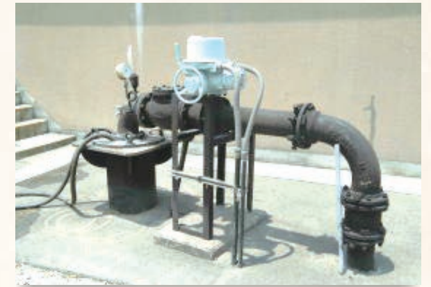
地下水をくみ上げる井戸 (泉浄水所内 1号井戸)
