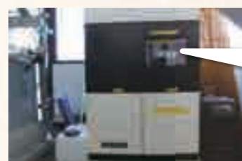
魚類監視装置
