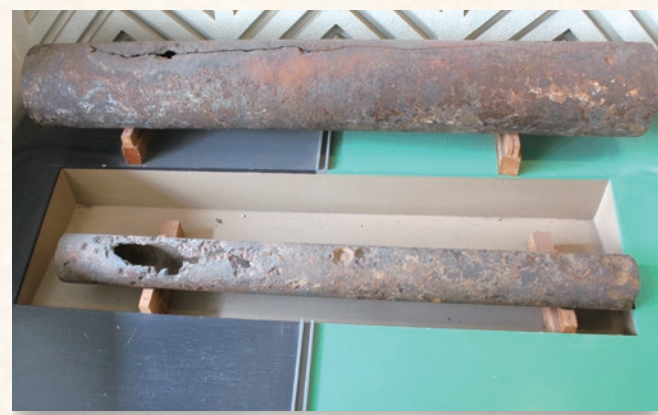
写真7-3 老朽化した水道管
