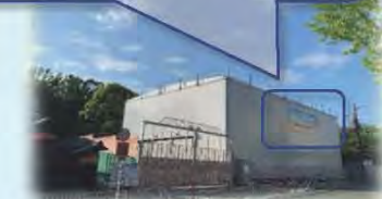
シールドマシンの発進基地に 設置していた防音ハウス
