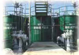
前処理ろ過機 鉄除去
