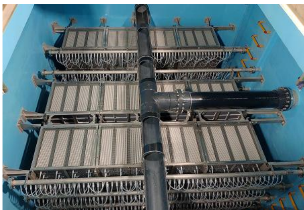
片山浄水所 膜ろ過設備
