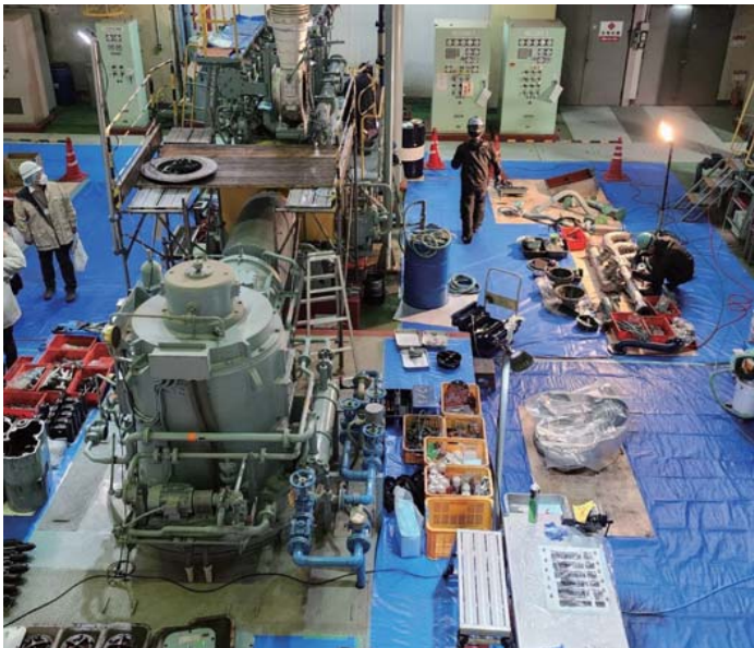
南吹田水再生センター雨水ポンプ
