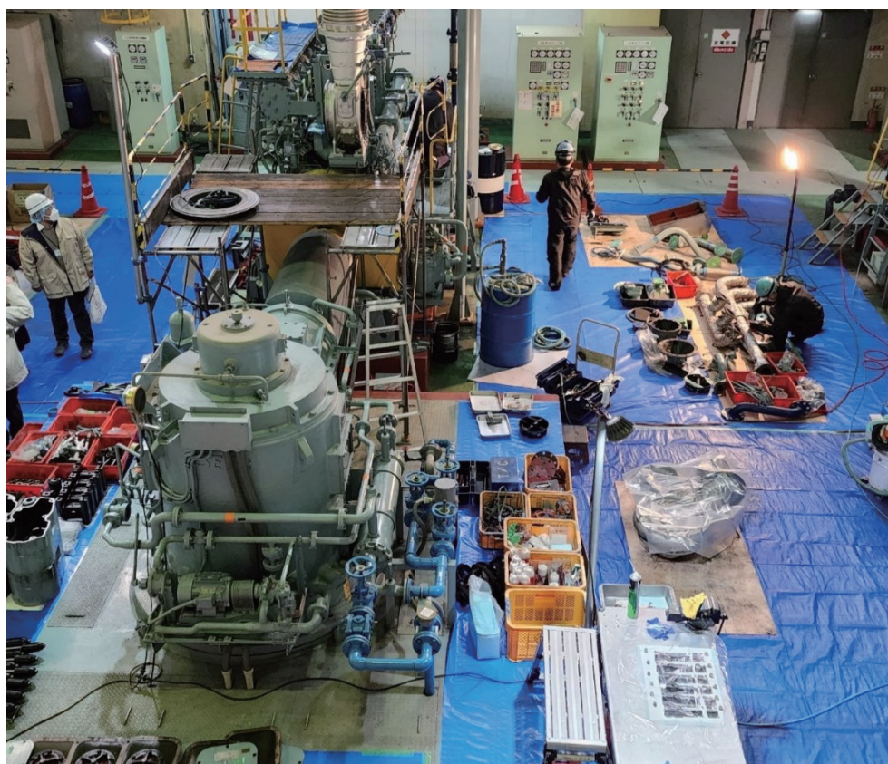
南吹田水再生センター雨水ポンプ
