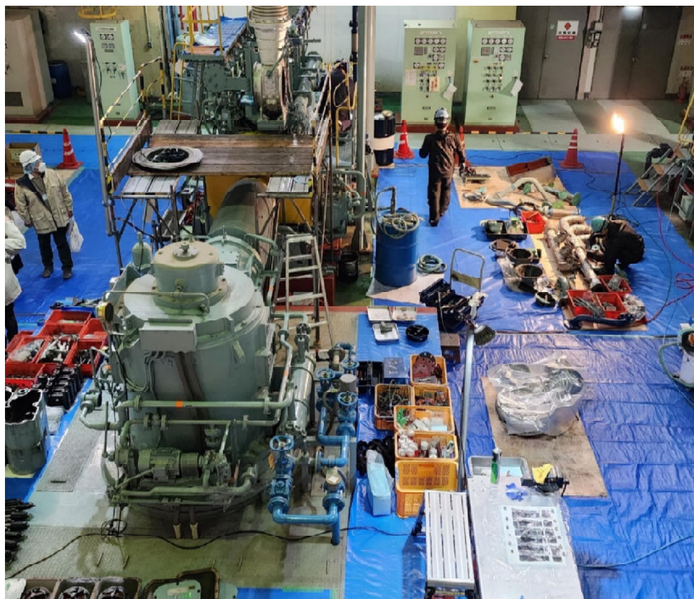
南吹田水再生センター雨水ポンプ
