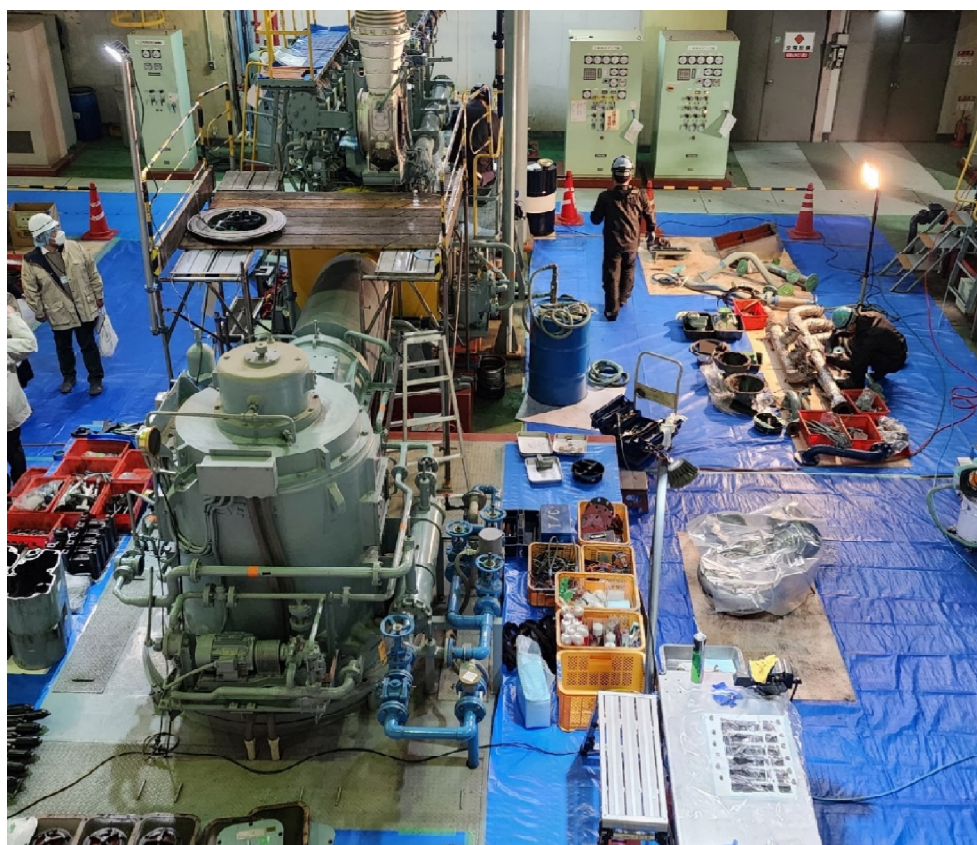
南吹田水再生センター雨水ポンプ
