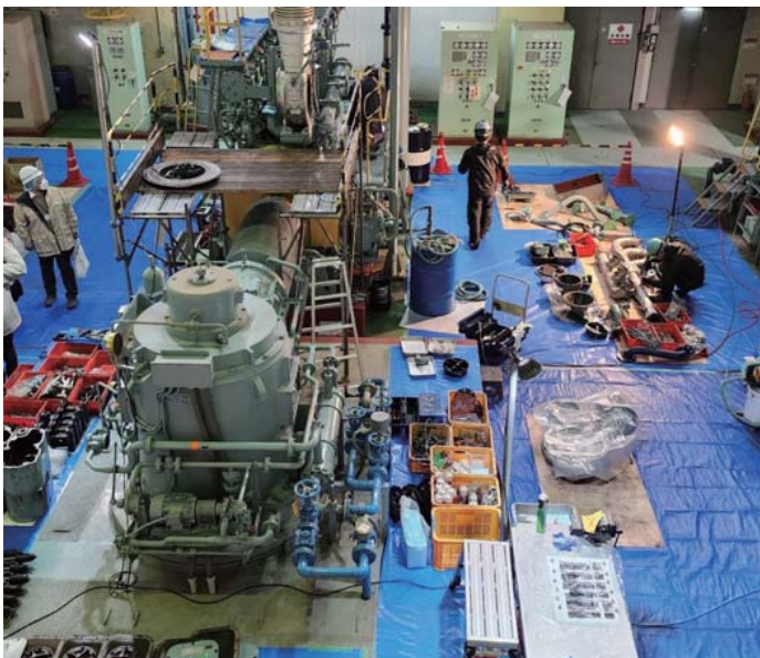
南吹田水再生センター雨水ポンプ
