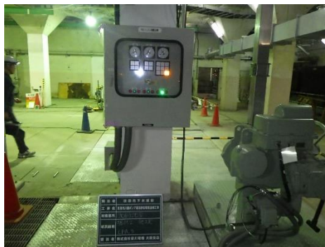
更新後（現場操作盤）
