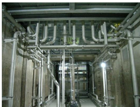
更新後（集砂・揚砂装置）
