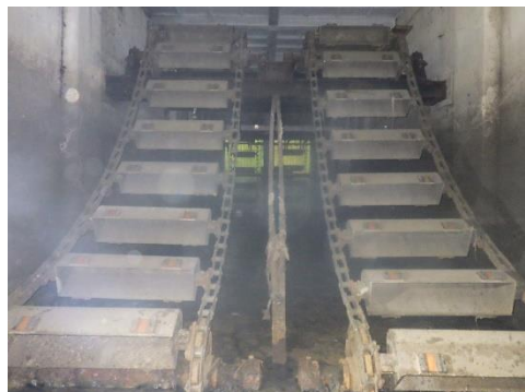
更新前（沈砂掻揚機）
