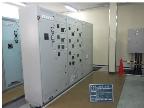
更新後（コントロールセンター）
