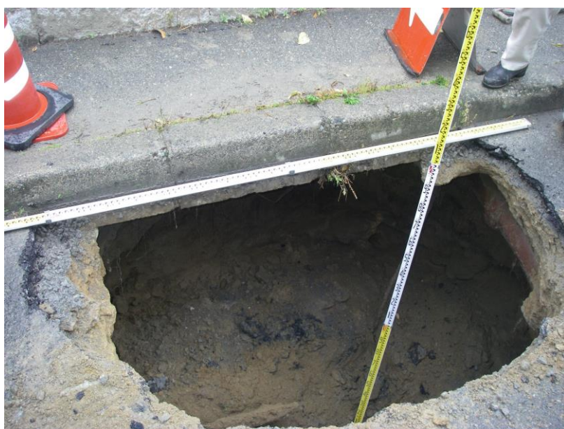
図 1-2 下水道本管起因の陥没状況（東御旅町）
