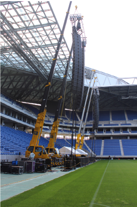
スピーカー設置状況
