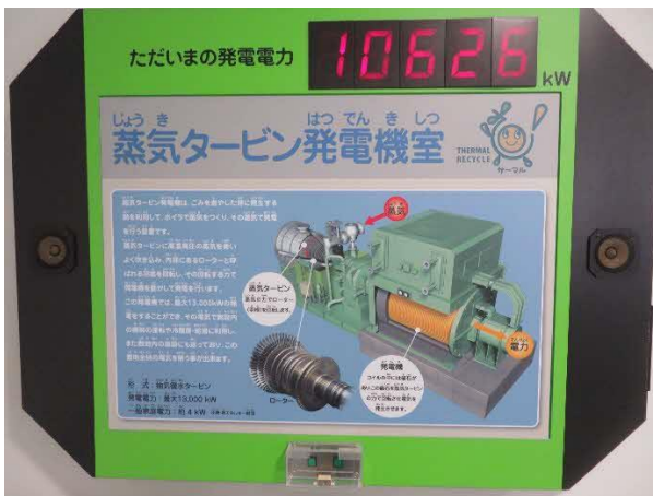
蒸気タービン発電機室（現在の発電量を表示）
