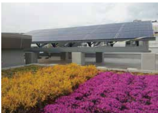
屋上の太陽光パネルと植栽
