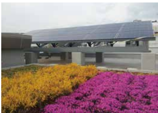
屋上の太陽光パネルと植栽
