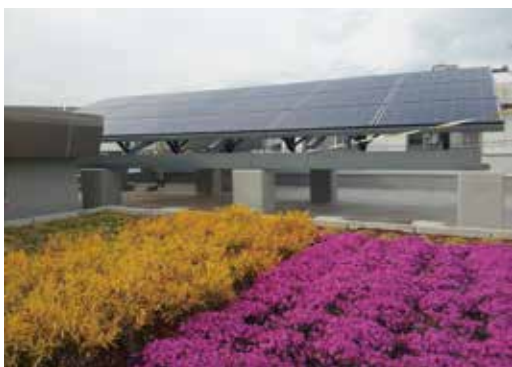
屋上の太陽光パネルと植栽
