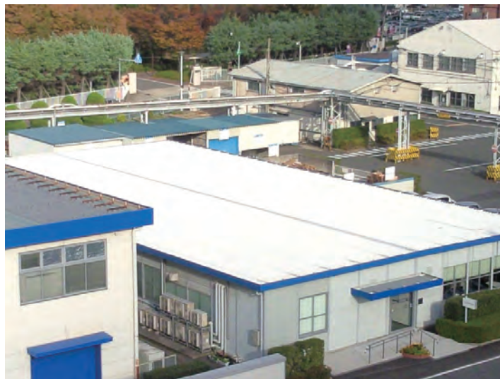
●屋根の高反射率塗料(TOTO株式会社小倉第一工場)
