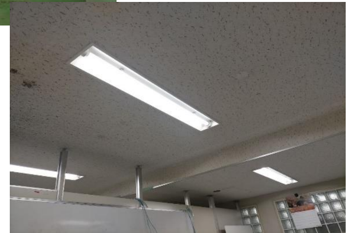
執務室(LED照明)
