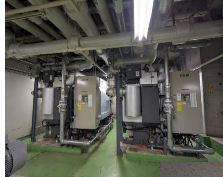
地下(ガス吸収式冷温水機)
