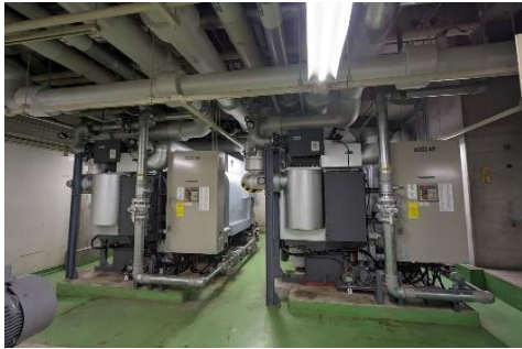
地下 (ガス吸収式冷温水機)
