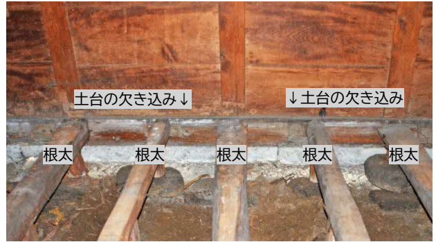
50 米蔵 床組解体 米蔵の床板を取り外したところ、根太を取り付けるための土台の欠き込みの痕跡が、現状とは異なる位置に残っていました。
