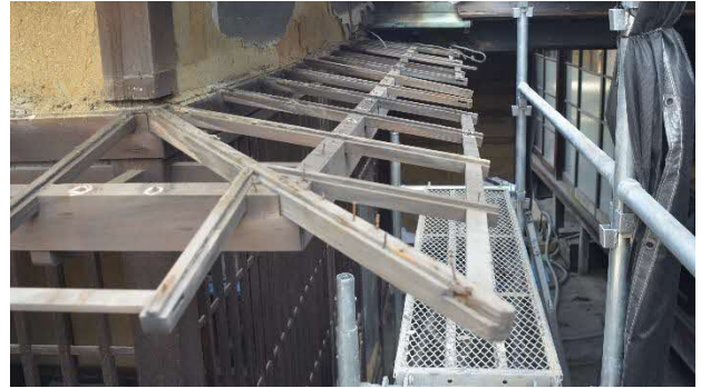
35 浴室棟 庇解体中 鉄板葺を解体したところ、垂木の上面が凸になった、少し変わった形式であることがわかりました。
