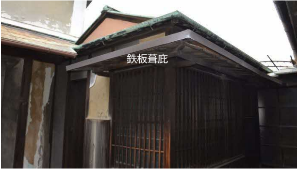
34 浴室棟 修理前 西南から見る 修理前には、庇は鉄板葺になっていましたが、明らかに近年の改造でした。
