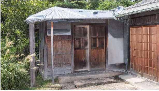
26 露地門・雪隠 修理前 東から見る 修理前の時点で、瓦をすでに降ろし、シートで養生していました。
