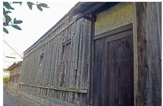
23 修理前 外塀(旧蔵納屋外壁) 道路側
