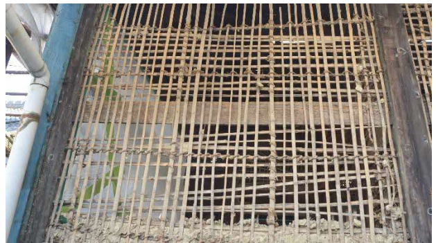
37 浴室棟 壁解体中 浴室棟の小舞下地は主屋の他の場所とは異なり、すべて竹を用いていました。浴室棟は後で増築された部分と言われていましたが、その証拠の一つとなりました。
