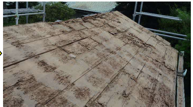
31 客便所棟 屋根解体中 しかし瓦を解体すると、雨漏りによって、瓦下の野地板の腐朽が進行していることがわかりました。
