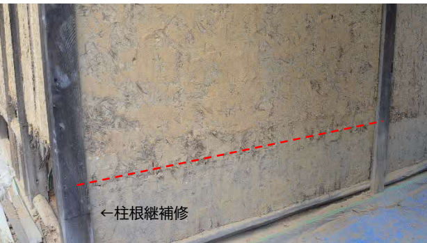
32 客便所棟 壁解体中 写真 30 の丸囲み部分を荒壁の状態まで解体した写真です。点線の上下で明らかに壁の状態が変わっており、施工をした時代が異なることが想定されます。また写真左の柱の根継補修とも関係がありそうです。
