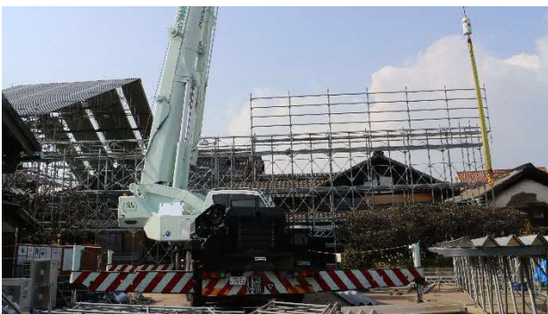
60 主屋・米蔵 素屋根建設中 主屋と米蔵の周囲に仮設の覆屋(素屋根)を建てて、解体中の建物が雨に濡れることがないようにし、天候に左右されずに工事を進めています。
