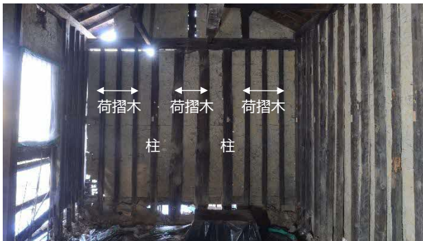
44 納屋(米蔵北) 解体中(南から見る) 納屋(米蔵北)の室内北面、東面と西面の一部には、柱と柱の間に荷摺木という材(室内に米俵などを持ち込むときに、土壁に直接ぶつかるのを防ぐ)が建てられていました。
