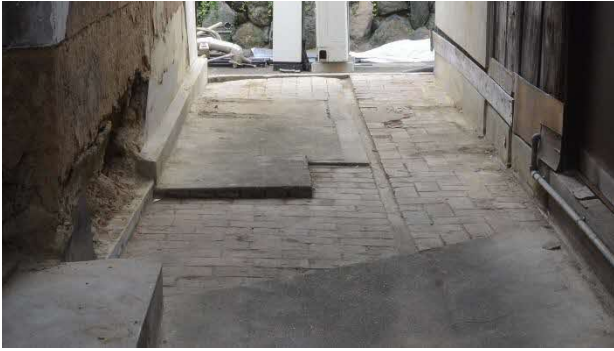
54 主屋-米蔵間通路 修理前 主屋と米蔵の間の通路は煉瓦敷きで、一部モルタル塗りとなっていました。
