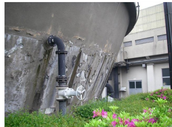
泉浄水所 高速凝集沈殿池
