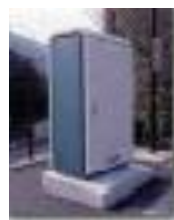
給水モニター
