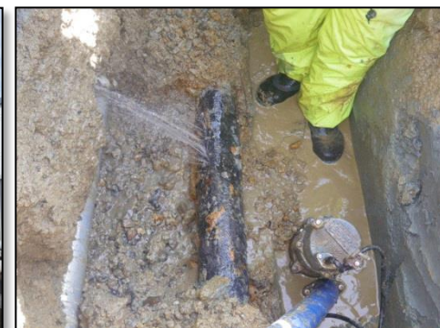
配水管漏水状況
