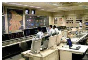
浄水管理センターで 集中監視
