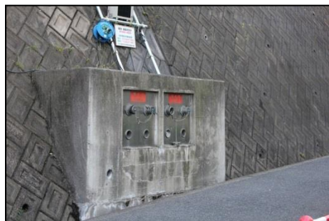
応急給水設備
