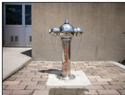
災害時応急給水栓
