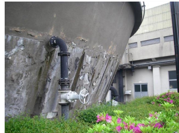
泉浄水所 高速凝集沈殿池
