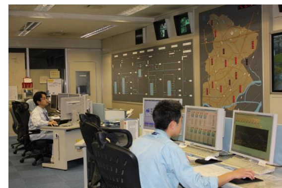
浄水処理施設 運転管理
