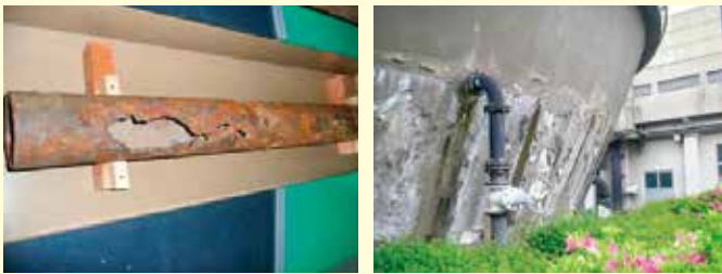
老朽化した水道管・施設
